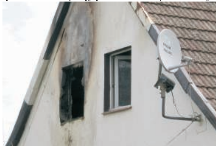
Spalone poddasze nadaje się do gruntownego remontu.
