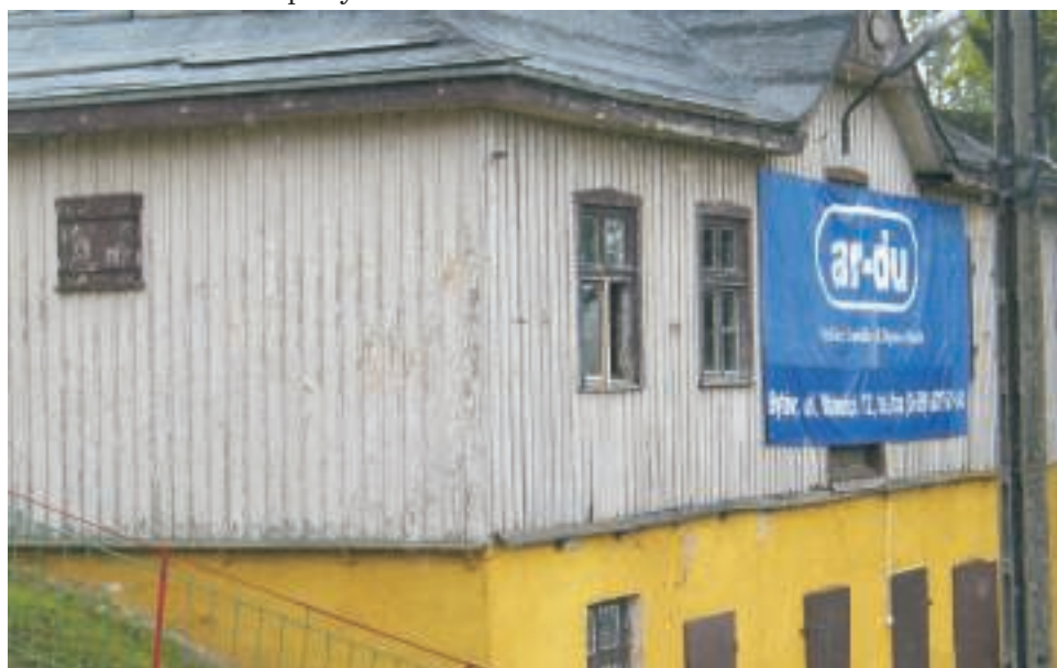
To zły czas dla bytowskiego MOSiR-u. Obiekt popada w ruinę, jak ten widoczny na zdjęciu Dom Piłkarza. Do tego dochodzą konflikty klubu z dyrekcją Bytovii.
