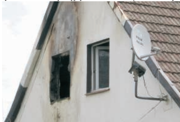
Spalone poddasze nadaje się do gruntownego remontu.
